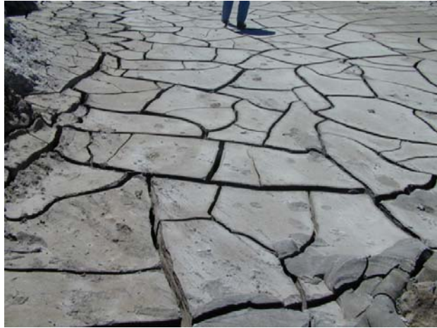
Figura 24: Arcillas fisuradas por desecación (Dique de cola Bajo Alumbreira).
