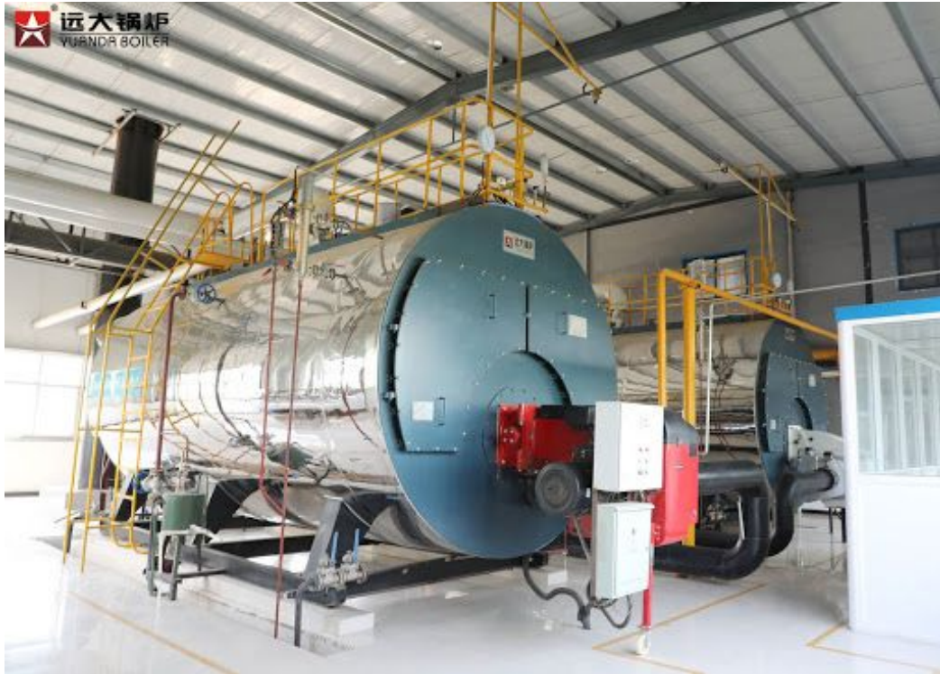
En la imagen se pueden apreciar una caldera industrial a vapor, la cual es un recipiente cilíndrico horizontal de proceso
