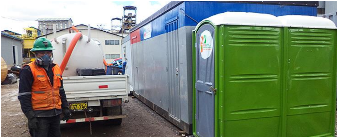
Recolección y tratamiento a través de la utilización de los baños químicos (lo más común en las obras)
