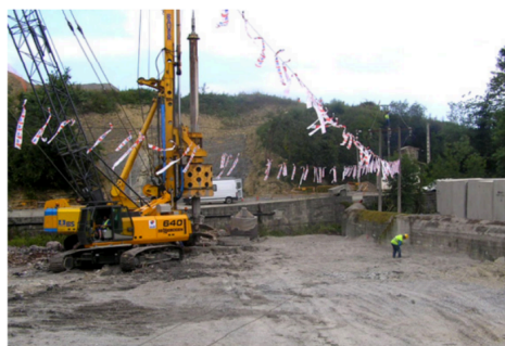
Pórticos para la delimitación de altura y zona de seguridad en presencia de línea eléctrica.
