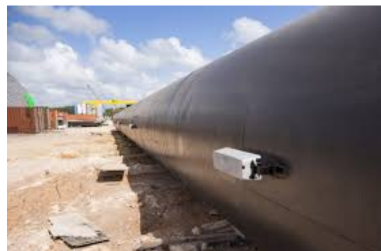
Figura 5: Tuberías y conducciones
