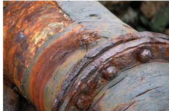
Figura 9: Corrosión tubería B
